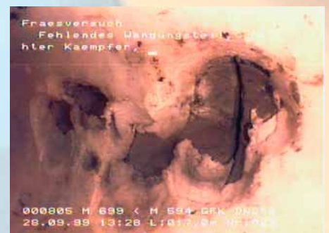
Abb. 1: Fehlversuch Auffräsen eines Anschlusses [R. Dilg]
