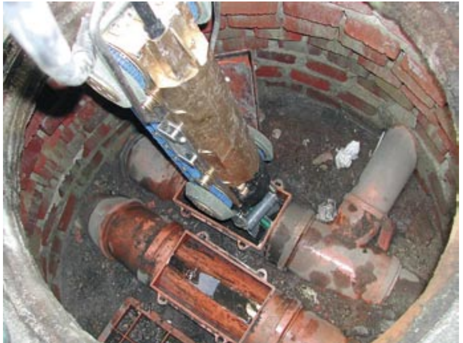
Einsetzen einer „Lindauer Schere“ über einen Revisionsschacht. Für den Kamerakopf stellen auch rechtwinklige Zuläufe wie der im Bild kein Problem dar. Foto: JT-Elektronik
