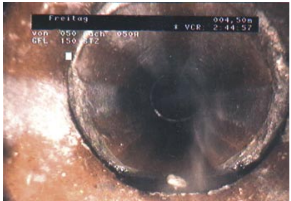
Undicht oder nicht - das Konzept der optischen Dichtheit zwangsläufig immer wieder zu Streitfällen, die sich letztlich nur durch eine Wasserdichtheitsprüfung klären lassen. Gerade bei alten Leitungen dürften solche Bilder regelmäßig auf Undichtheit hinweisen. Foto: Grundstücksentwässerung ONLINE
